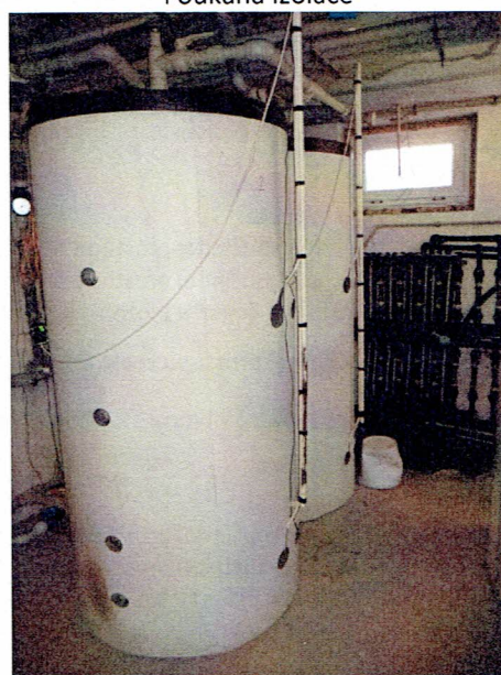
Akumulační zásobníky – systém ÚT
